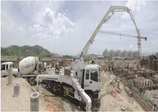
Xây dựng công trình ở Phúc Kiến sử dụng thiết bị công nghệ cao.
